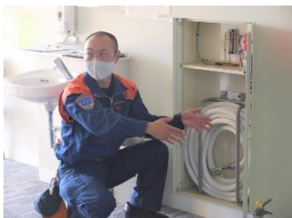
消防署職員による防火設備の説明①
